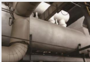
回收锅炉热能系统
